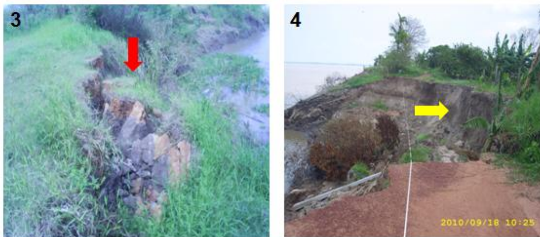
FIGURA 3 e 4: A figura 3 mostra a queda em bloco no sopé do barranco - subida das águas do rio. Na figura 4, é visualizado o escorregamento - tipo rotacional, identificando-se a forma côncava correspondente ao período da descida das águas.
