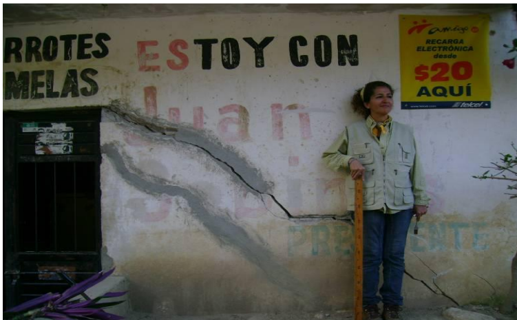
Foto 7. Grietas en casa habitación y reparaciones, Col, Lomas del Oriente. JP
