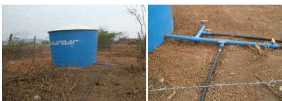
Figura 05: Captação coletiva de água.
