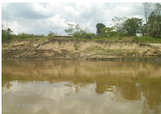
Figura 04- Escola Municipal abandonada ameaçada pelas terras caídas.
